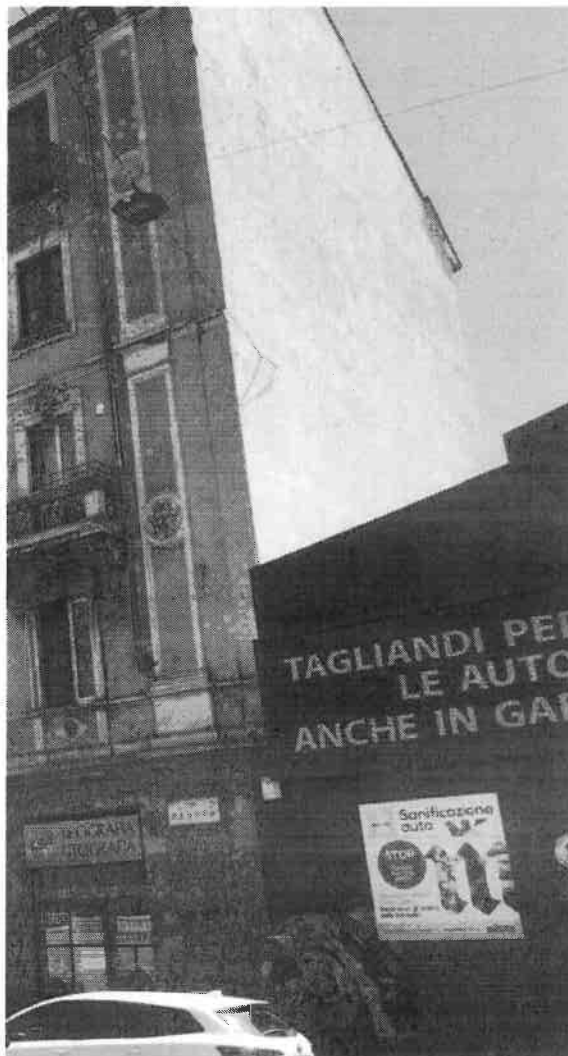
Fig.20: situazione prospetto lato sud-ovest durante il sopralluogo del 18.05.2021
