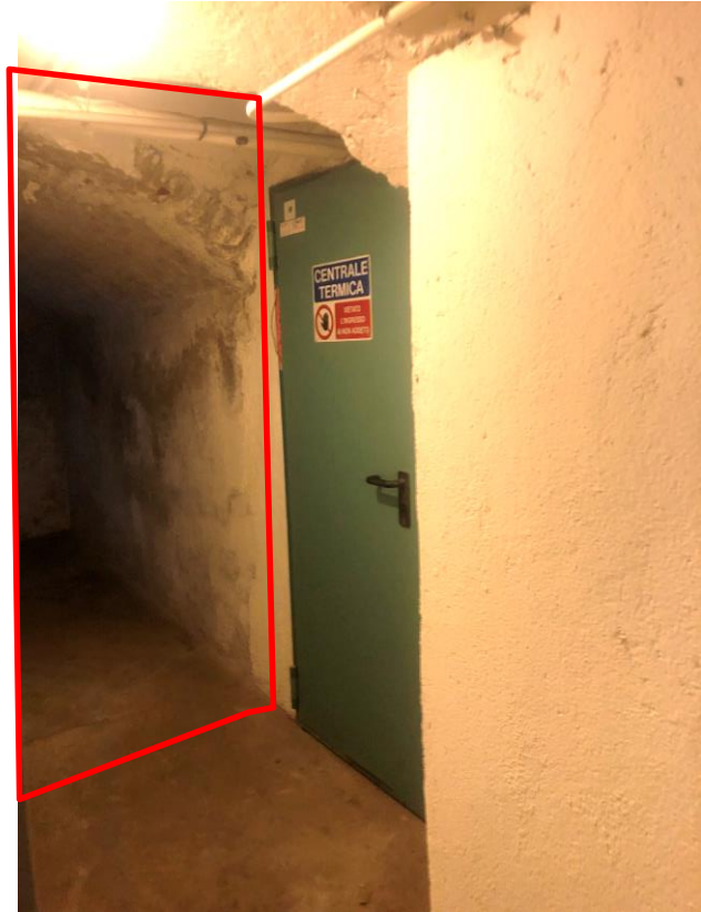
Vista disimpegno per cantina al sub 61 priva di porta
