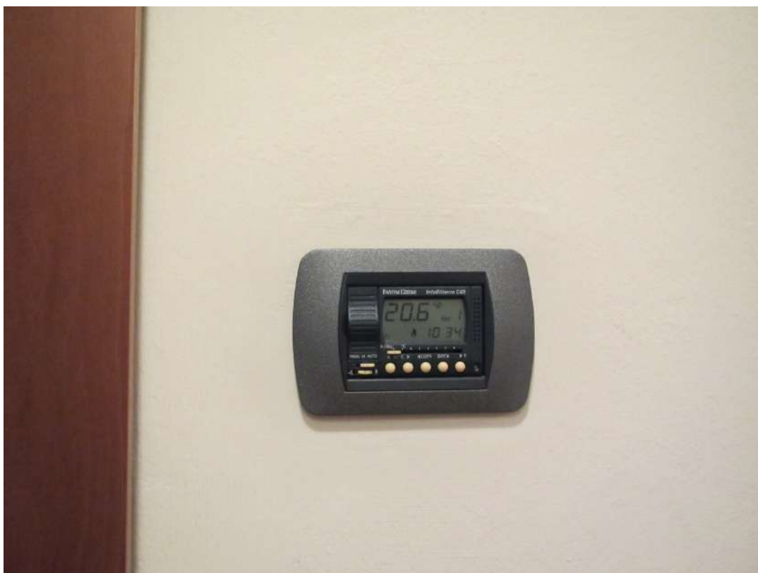
Dettagli - Impianto termico
