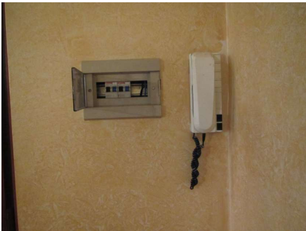
Dettagli - Impianto elettrico e citofono
