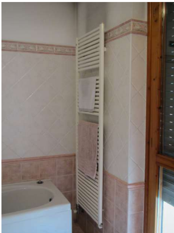
Dettagli - Impianto termico
