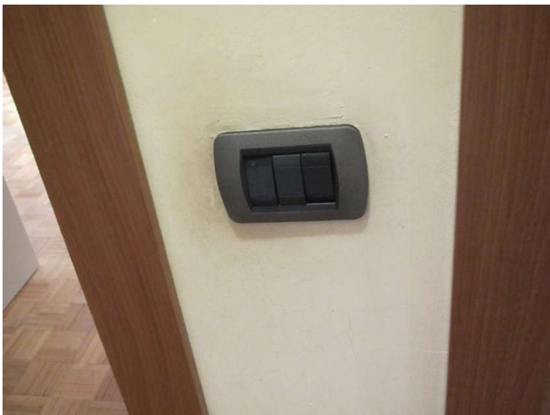
Dettagli - Impianto elettrico
