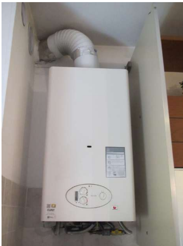
Dettagli – Caldaia autonoma per riscaldamento e acqua calda sanitaria
