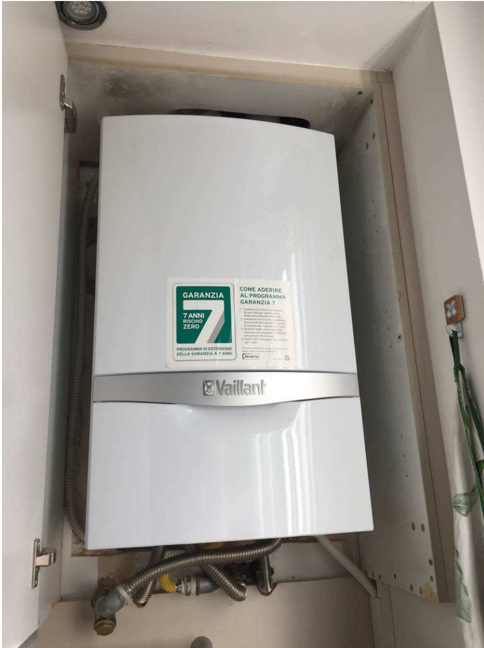
Fotografia n. 48 – Particolare della caldaia, posizionata nel locale cucina
