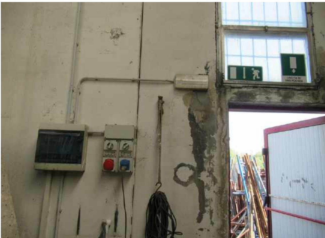
Foto 12: Quadro elettrico e uscita di sicurezza
