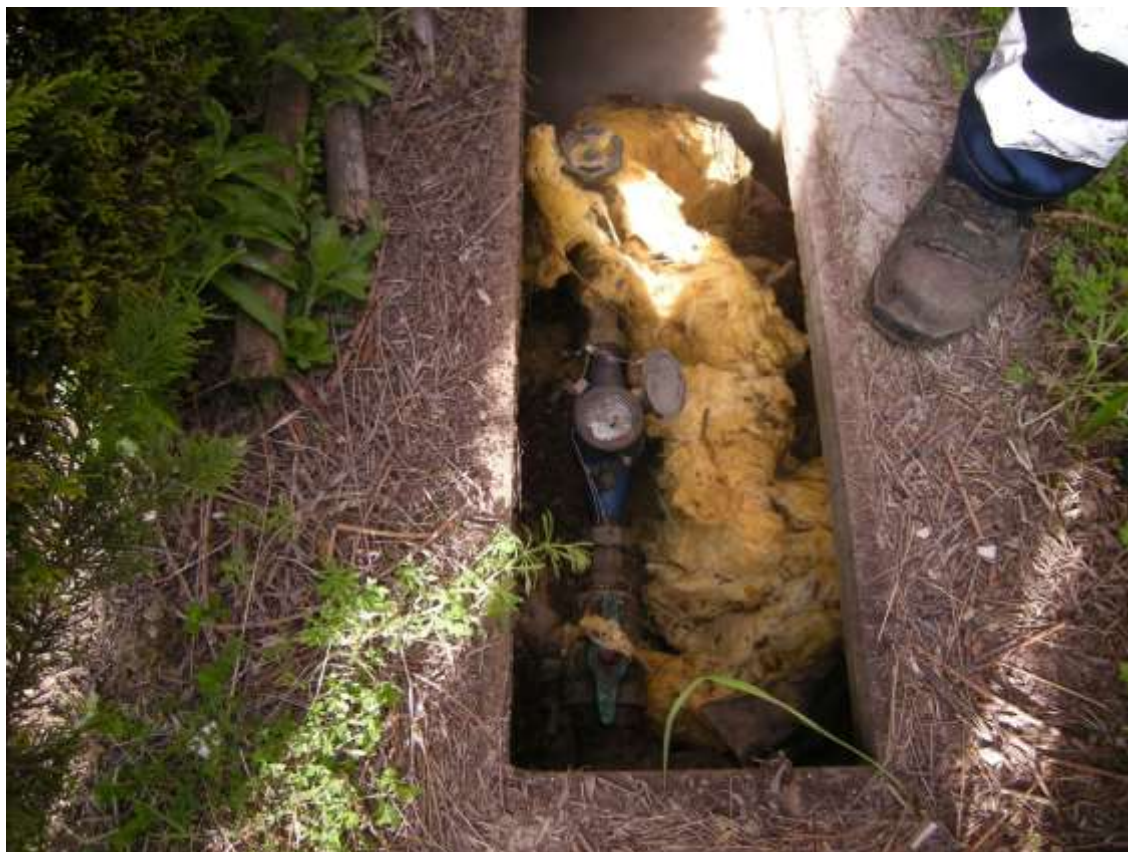
Ottava Presa (Caorle), Strada Fortuna n. 56 – Sopra nicchia contatori gas, sotto pozzetto contatore generale acqua.
