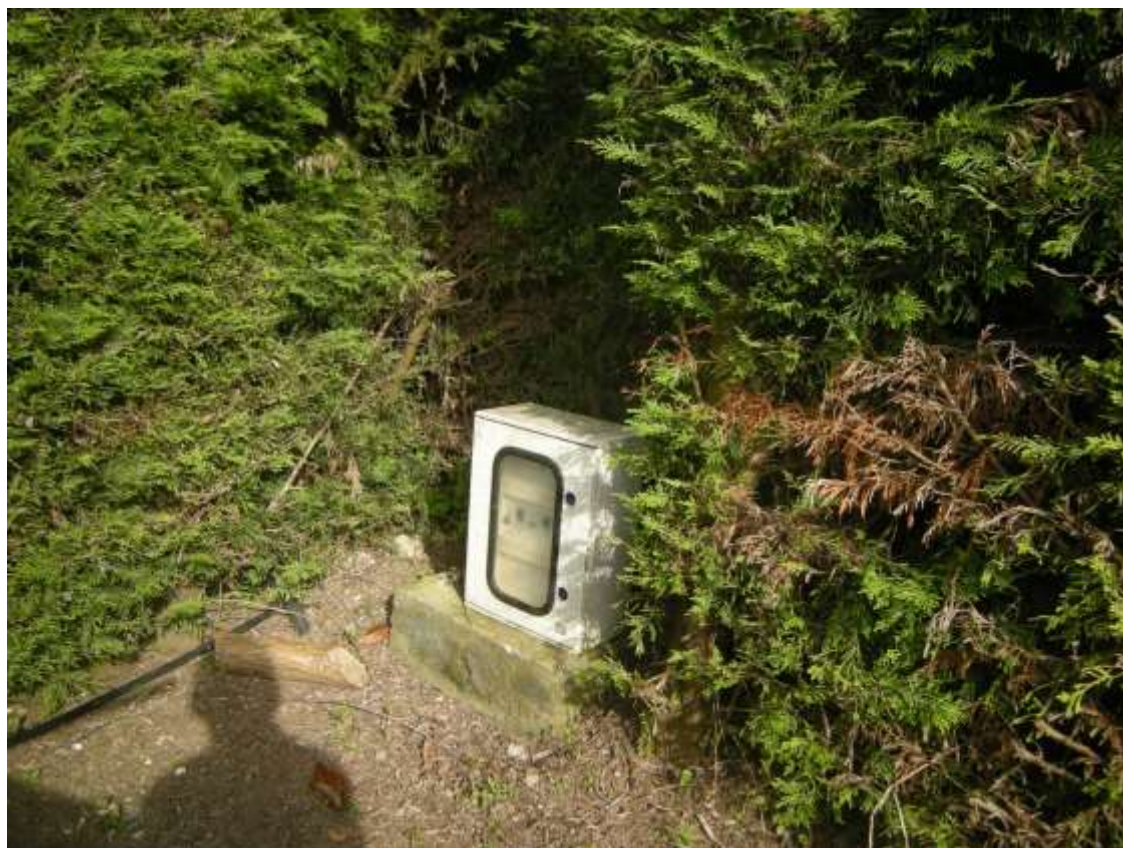
Ottava Presa (Caorle), Strada Fortuna n. 56 – Sopra vano contatori elettricit  e telefonia, sotto armadietto di comando luci esterne.
