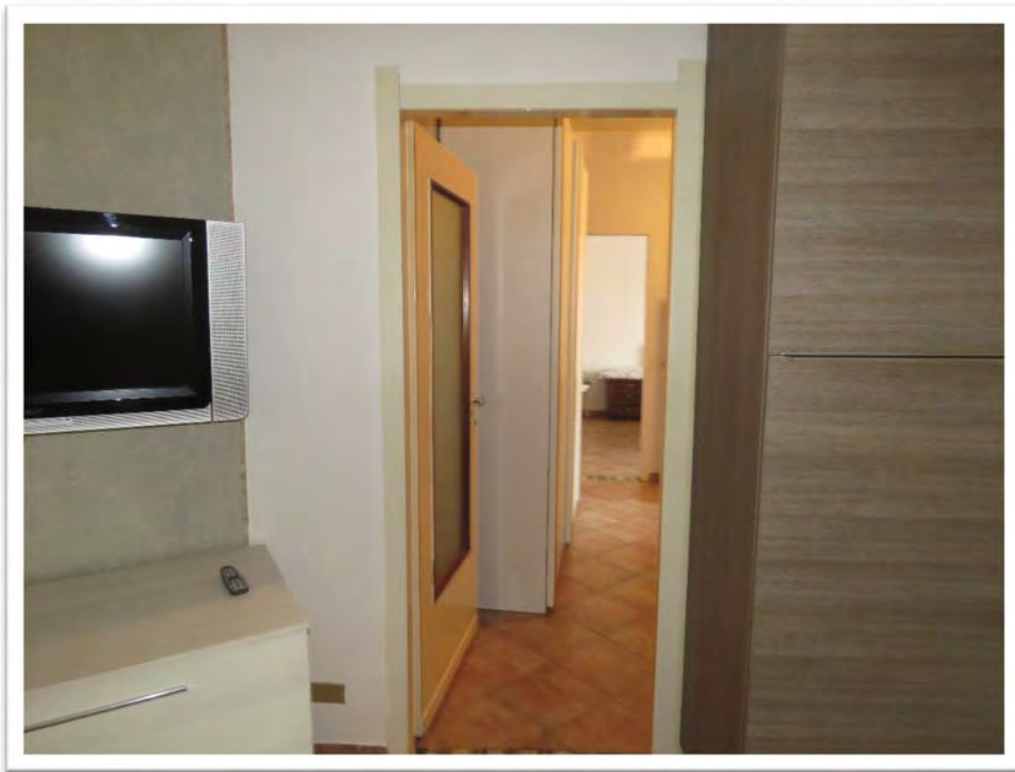
L'ingresso al disimpegno della zona notte (da notare il rappezzo del pavimento nel posto in cui è stata aperta la porta nella parete).
