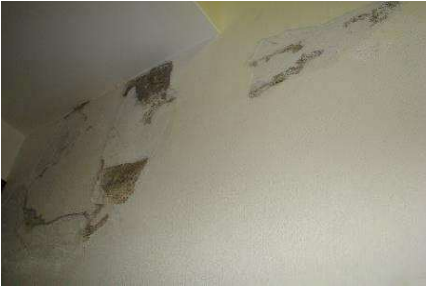
40. Dettaglio dei segni di infiltrazione presenti nel bagno.
