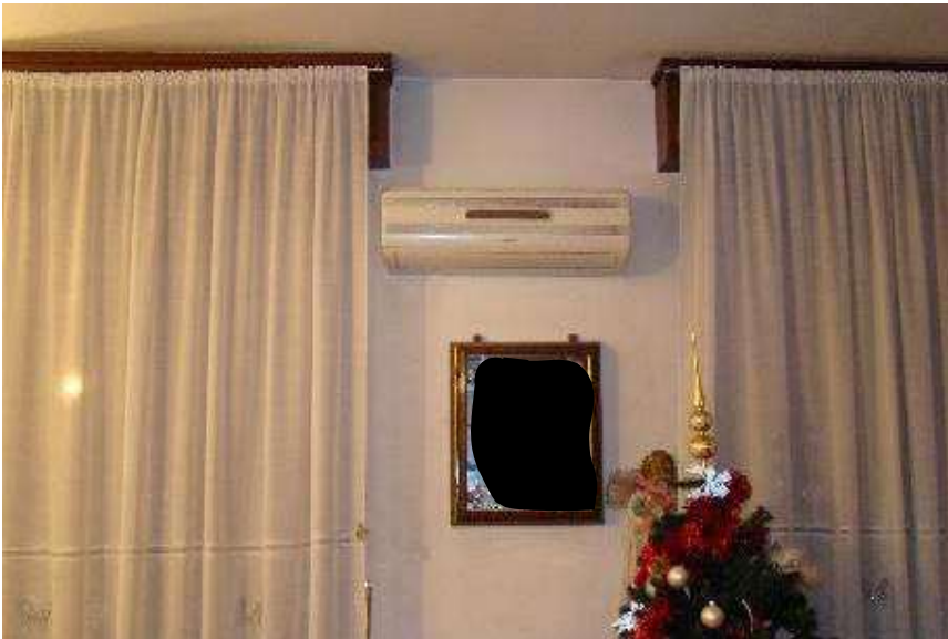
8. Dettaglio del condizionatore in soggiorno.
