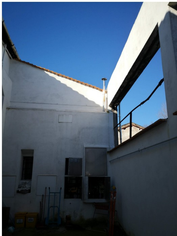
75- caldaia e impianto distribuzione
