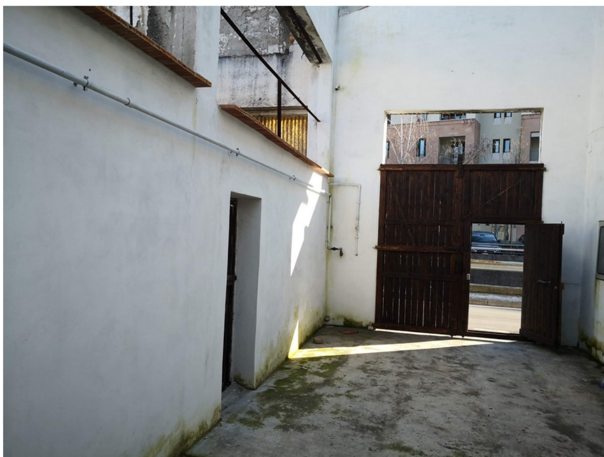
66 - tubo gas e cortile interno
