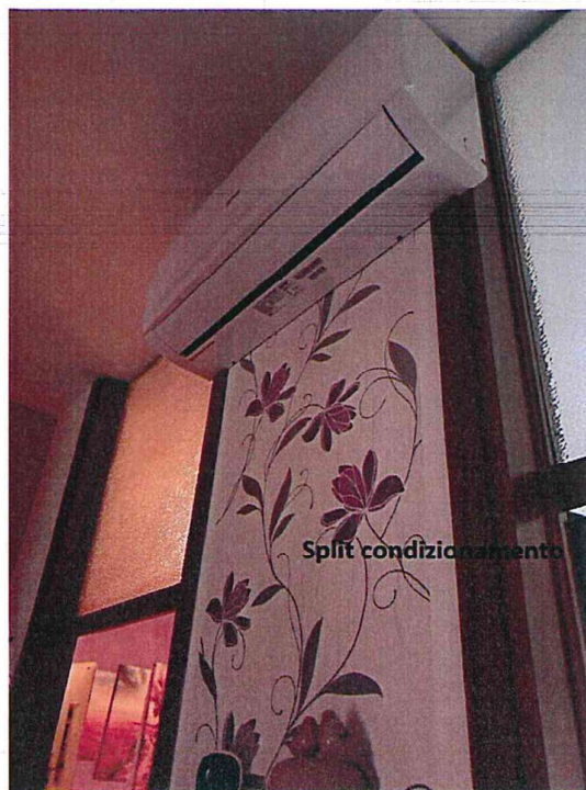
Fotografia G.9 - condizionatore split
