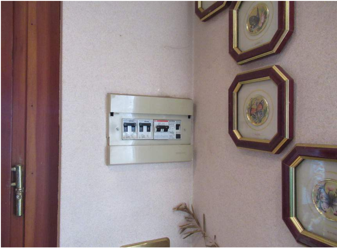
Foto 7: Quadro elettrico nell'atrio
