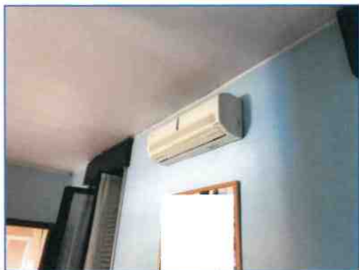
Foto 43 - dettaglio impianto condizionamento
