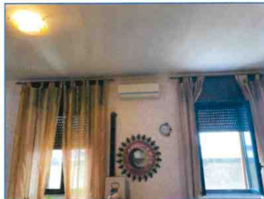
Foto 44 - dettaglio impianto condizionamento
