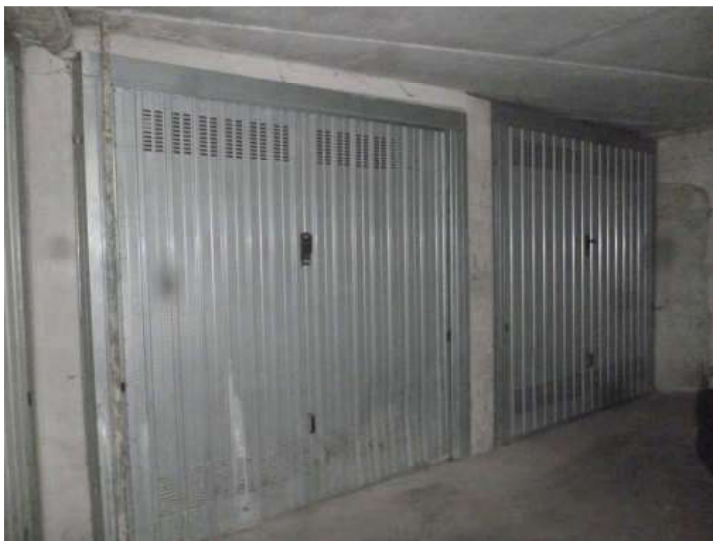
FOTO 16 - Box Sub. 24 a sinistra e Box Sub. 25 a destra. La basculante del Sub. 24 è bloccata dal tamponamento interno.
