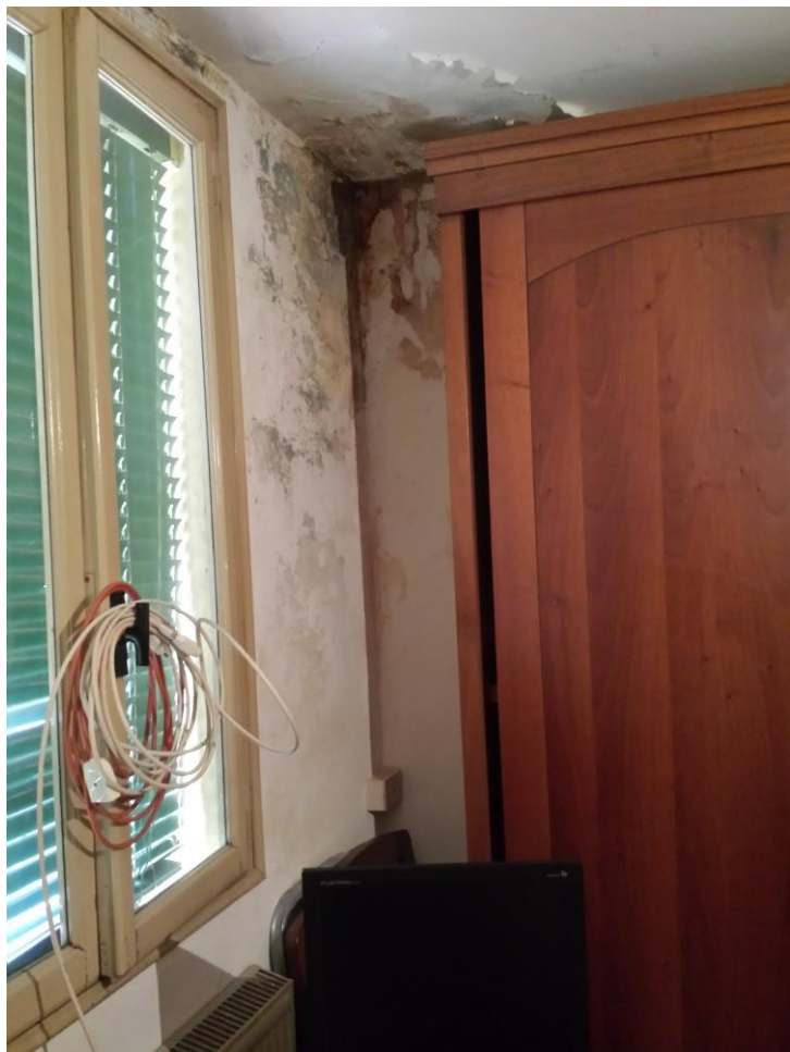
Particolare infiltrazione camera P1
