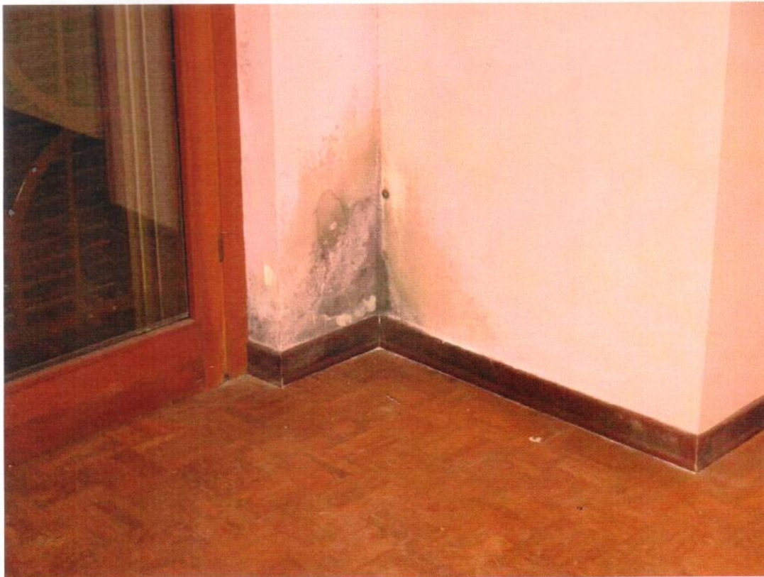
Dettaglio: presenza di muffe
