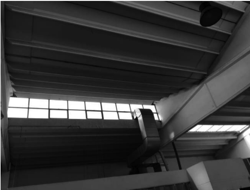
Foto 14 – aerazione impianti e finestratura
