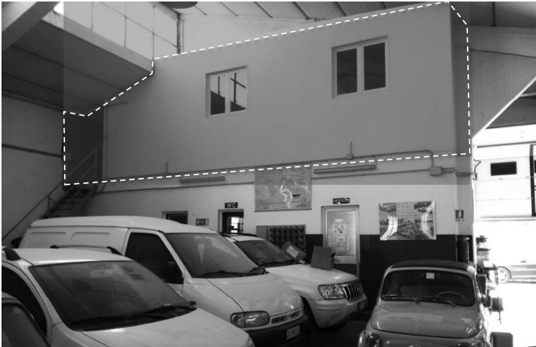
Foto 18/22 – zona piano primo non liceizzata
