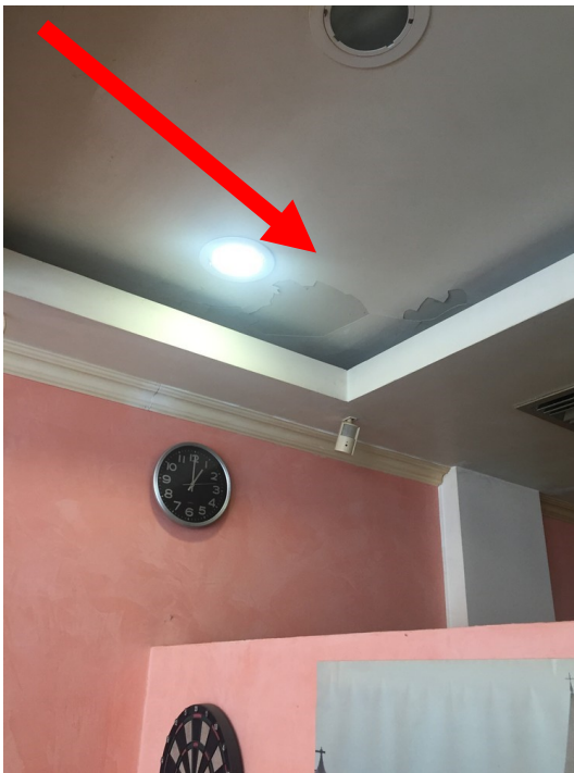
vista difetto di distacco tinteggiatura dal soffitto
