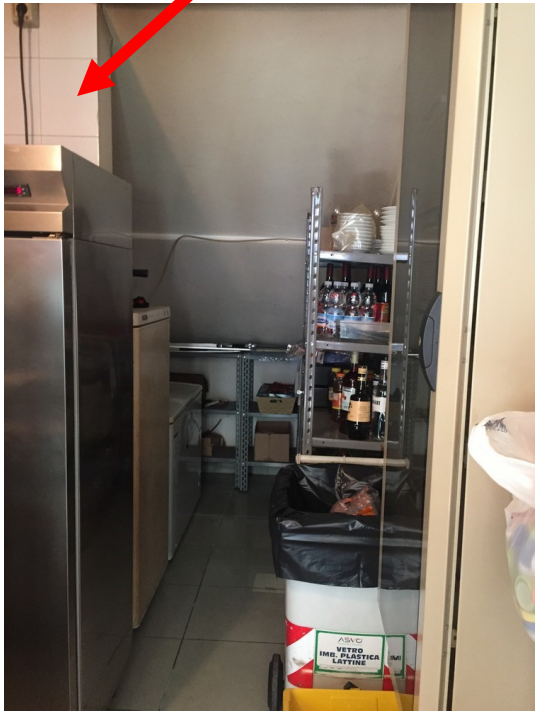
vista difformità di una parete nel sottoscala
