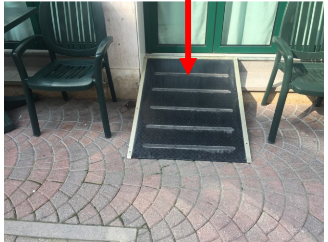
vista difetto di pendenza della rampa disabili
