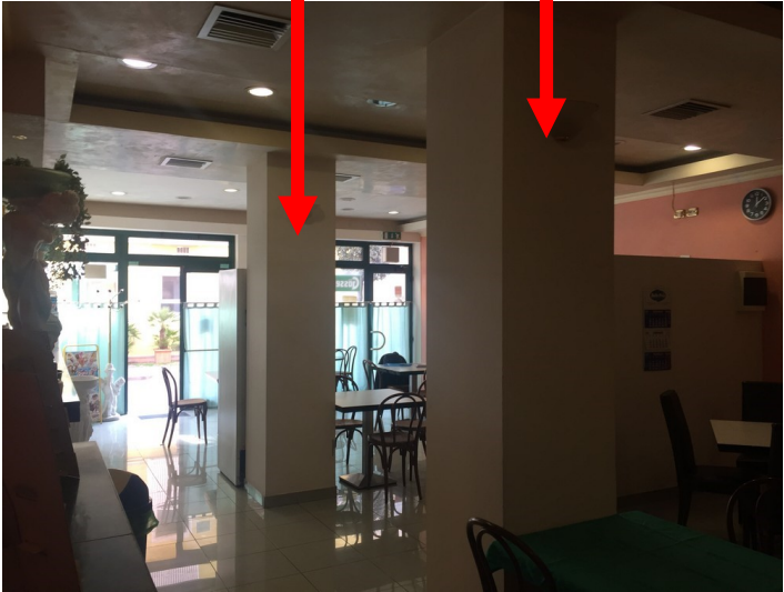
vista difformità per allargamento della sezione di due pilastri centrali
