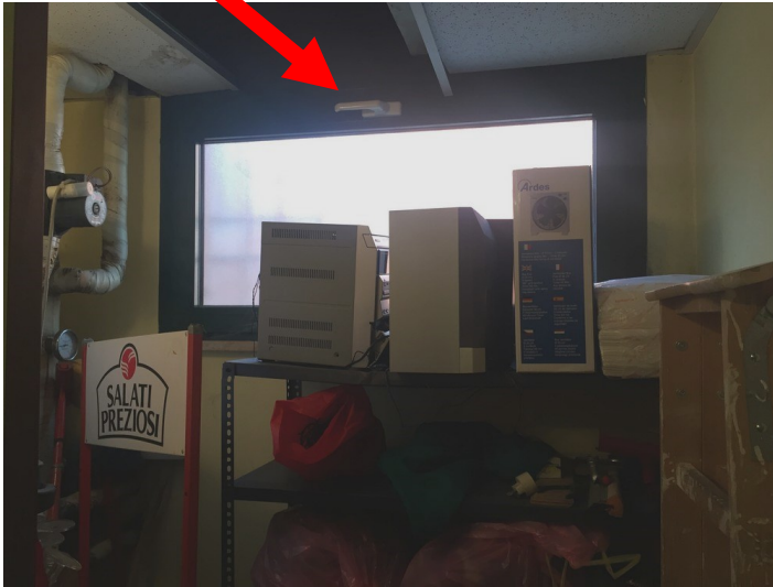
vista difetto nel soffitto del ripostiglio
