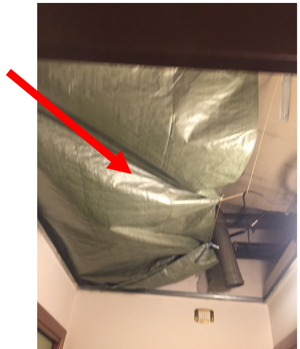
vista difetto per mancanza del soffitto nel corridoio
