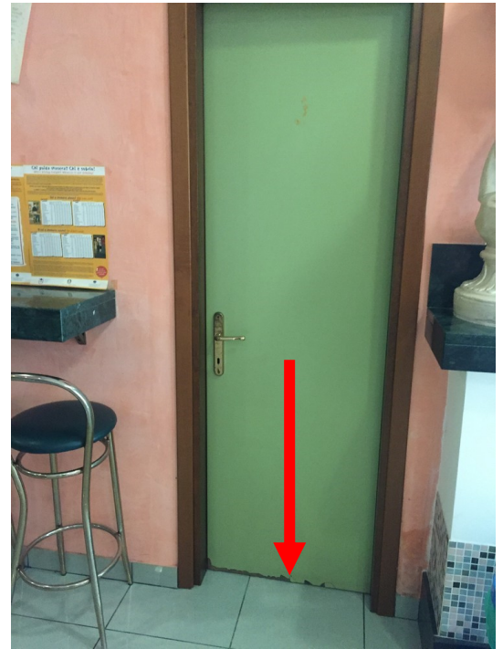
vista difetto nella porta di accesso al corridoio
