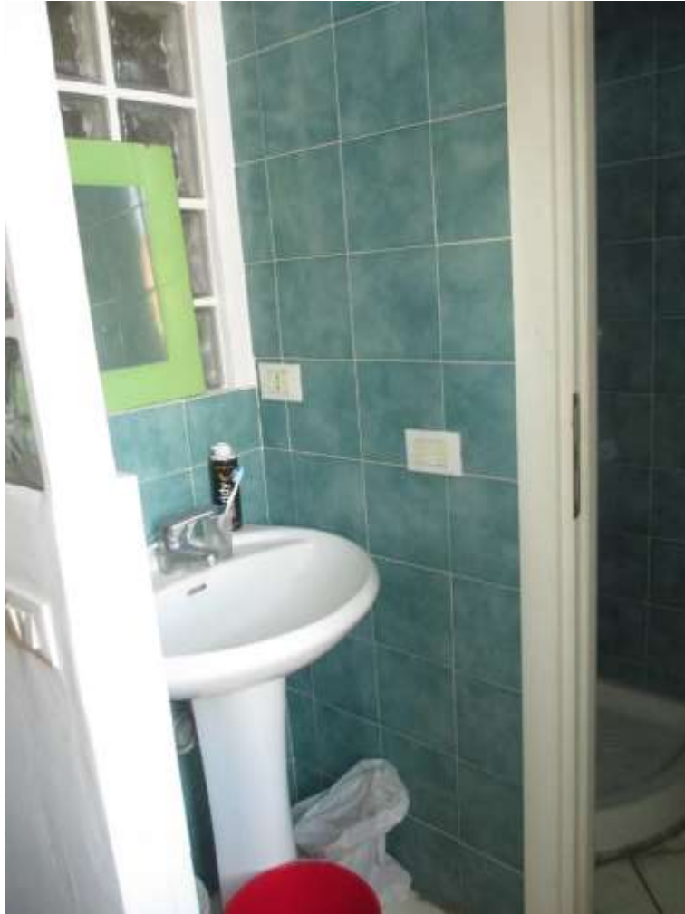
Foto 4: lavandino in quello che doveva essere l'antibagno. Manca bidet
