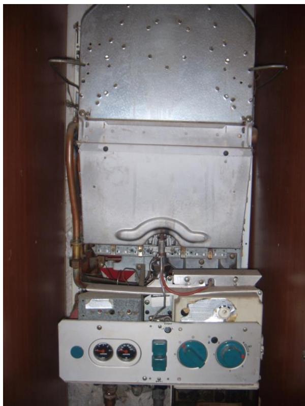
PARTICOLARE DELLA CALDAI DI RISCALDAMENTO
