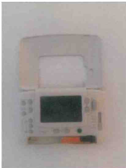
Regolatore impianto riscaldamento
