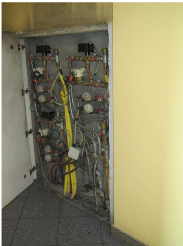
Dettagli – Contabilizzatori individuali degli impianti termico e idrico
