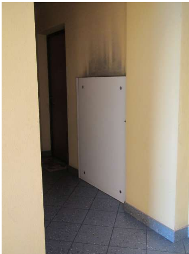
Dettagli – Box contabilizzatori individuali degli impianti termico e idrico
