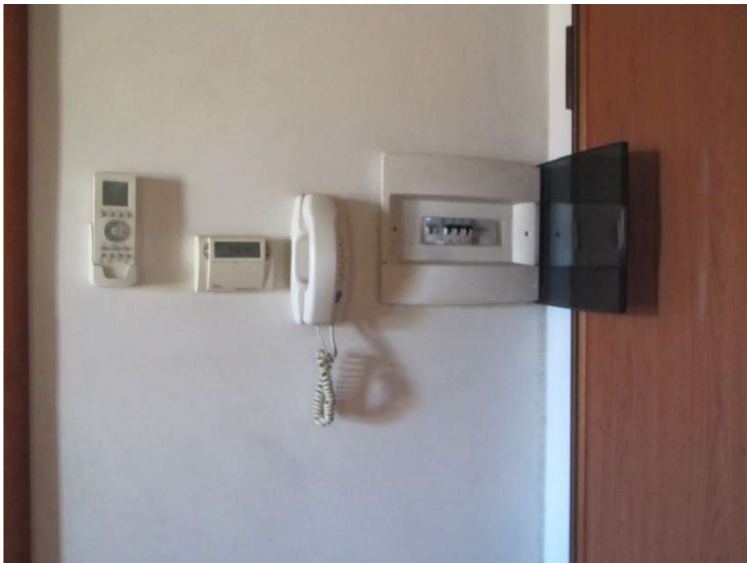
Dettagli - Impianti elettrico, citofono e termostato ambiente
