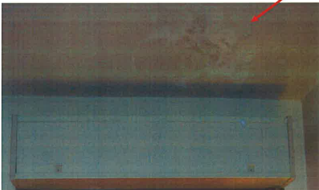
Dettaglio: plafone con macchia di infiltrazione
