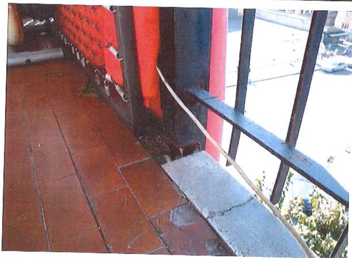
R.G.E. 1097/2017, G. E. Dott. Ssa M. G. Mennuni Pioltello, Via Cilea n.° 3, Scala M, piano 4°, Foglio 2, mapp. 589, sub. 17 Prospetti esterni: particolari del balcone con i montanti in ferro danneggiati
