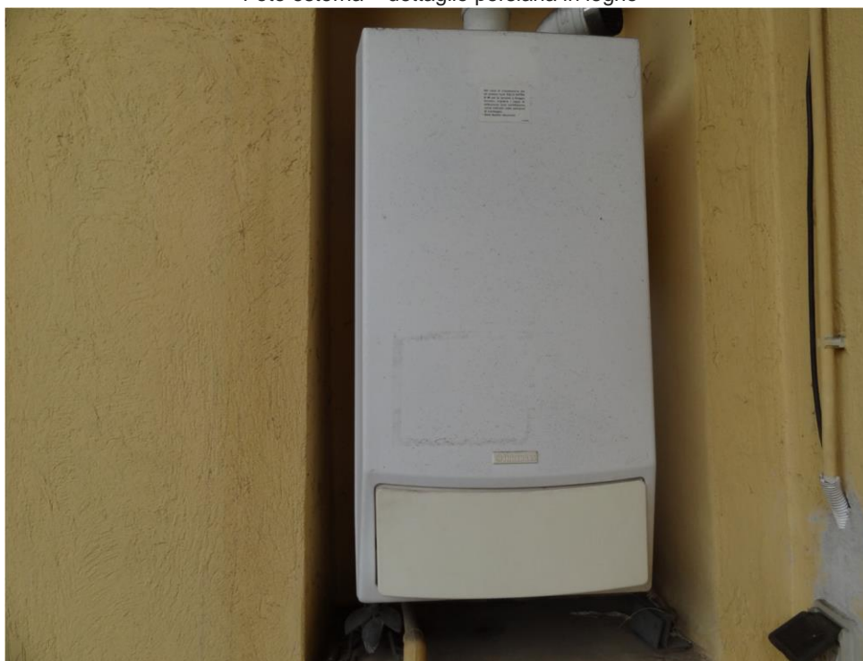
Foto esterna – dettaglio caldaia
