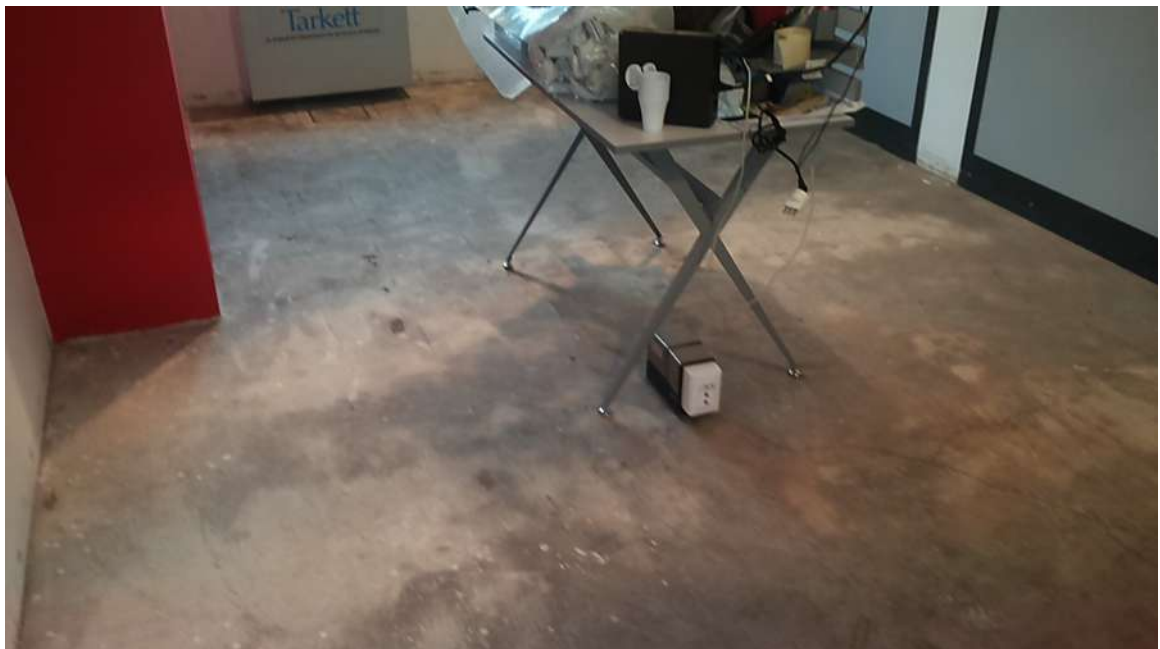
FOTO ESEGUITE DOPO LE FORTI PIOGGE DI INIZIO AGOSTO 2019
