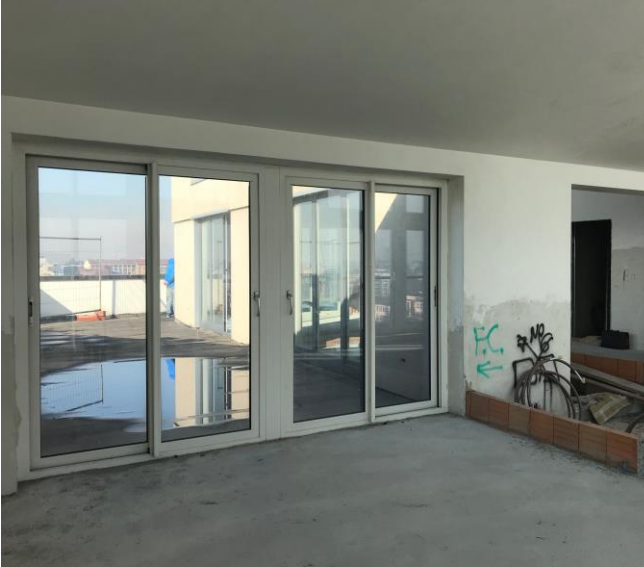
Foto 14. Vista dell'interno e dell'esterno con la presenza di una zona di ristagno di acqua (che evidenzia la presenza dell'impermeabilizzazione ma anche di mancanza di deflusso. Serramenti di facciata e del portoncino di ingresso sono installati.
