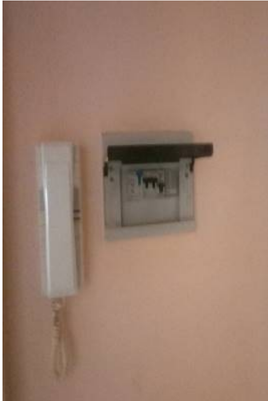
Citofono e quadro elettrico
