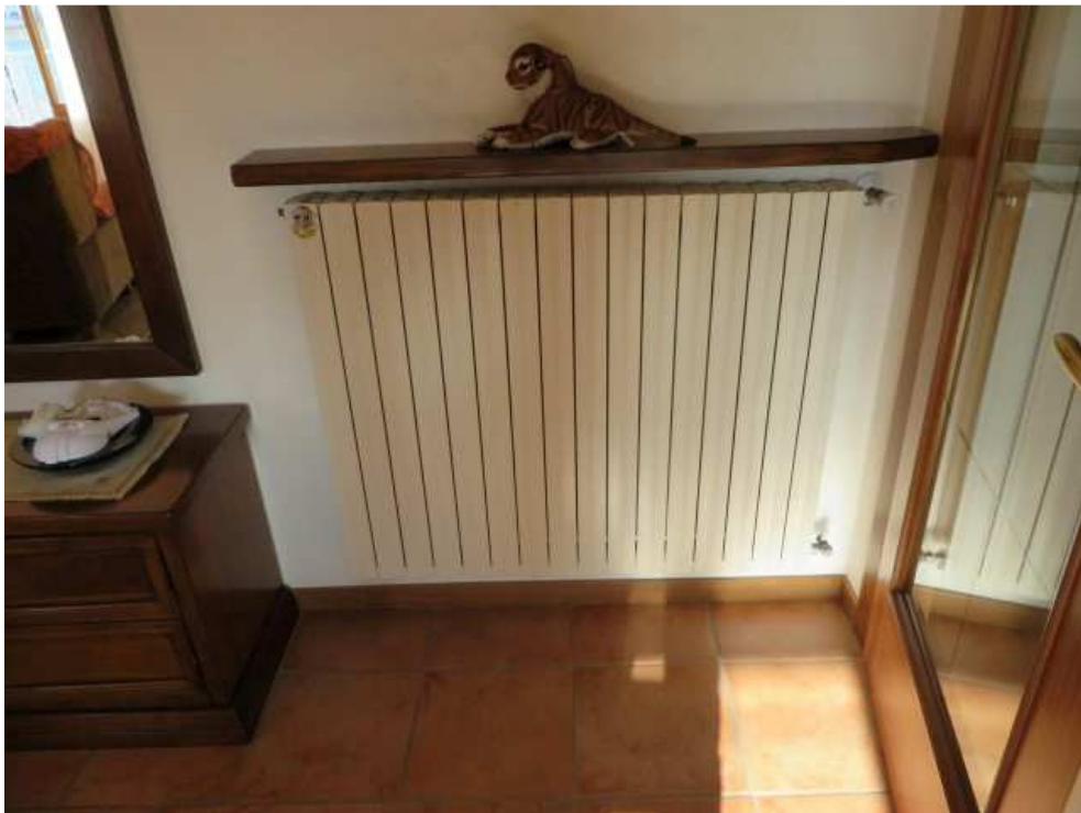
FOTO 56: PARTICOLARE RADIATORE (Secondo Piano)
