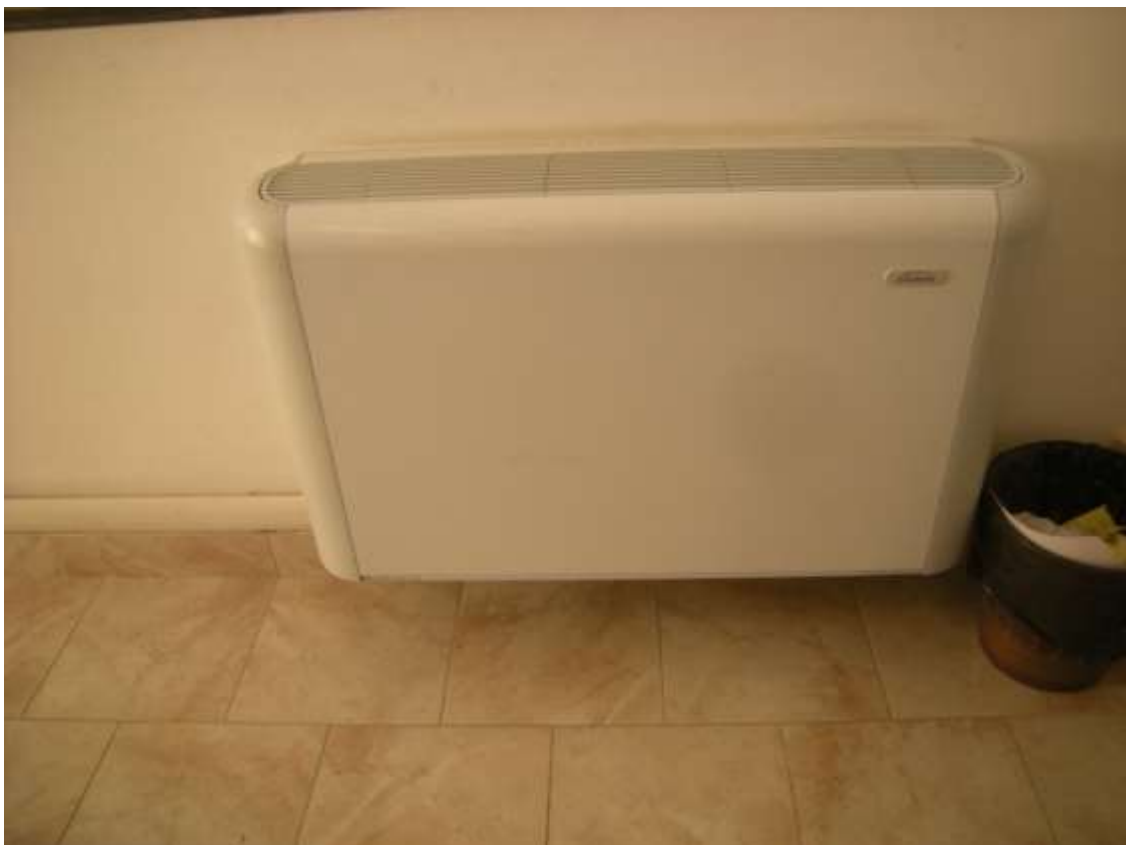
Concordia Sagittaria, foglio 5 particella 930, sub. 11 - Particolari dell'impianto di riscaldamento.
