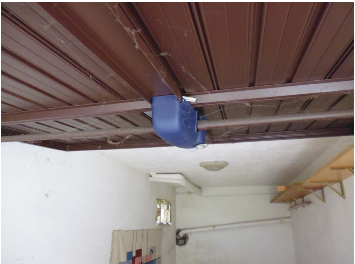
Foto 23 – garage dotato di apertura automatica del portone
