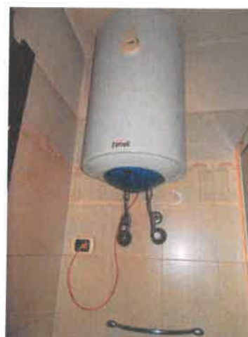
30. Boiler all'interno del bagno
