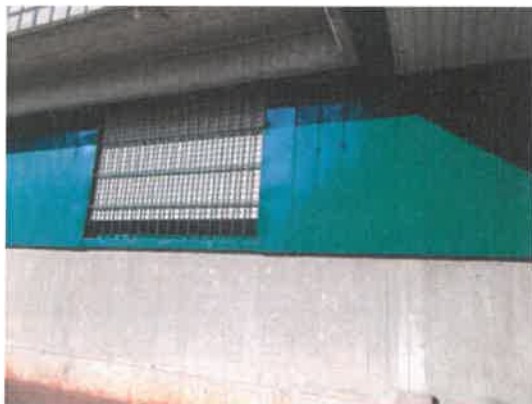
11. Finestra dell'immobile pignorato
