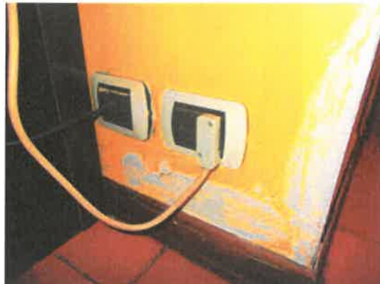
32. Dettaglio presa elettrica
