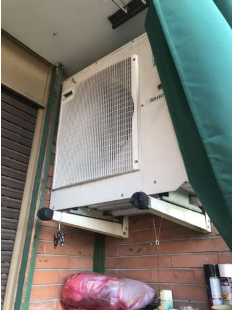
Foto 16. Vista di dettaglio della posizione del motore dell'aria condizionata, collocato sul balcone accessibile dal soggiorno.
