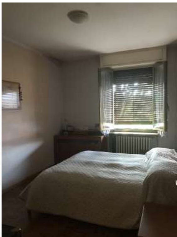
Foto 11. Vista della camera da letto matrimoniale, contigua alla precedente. Si nota nello spigolo in alto a sinistra il segno di una infiltrazione derivante dal sottotetto superiore.
