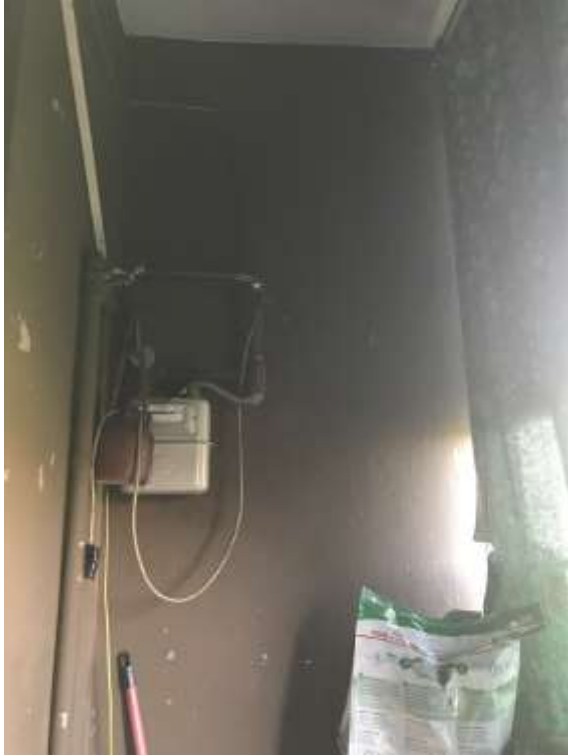
Foto 9. Vista del contatore del gas, collocato sul balcone accessibile dalla cucina.
