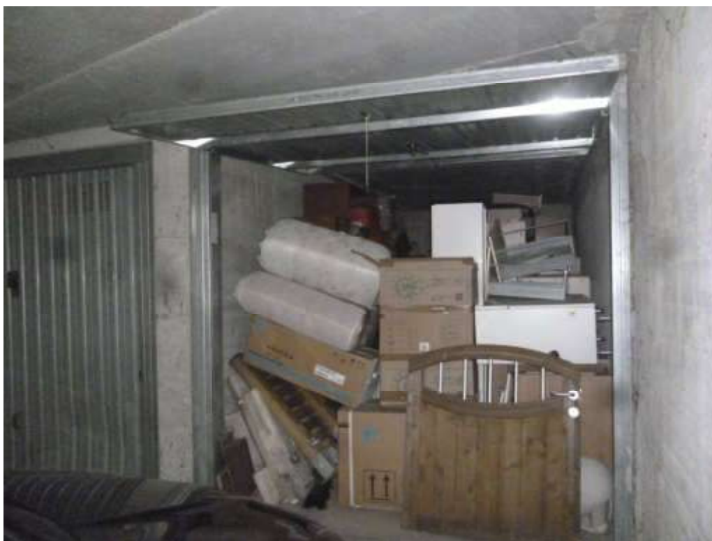
FOTO 20 - Box Sub. 25, stato attuale: ingombro ed inaccessibile
