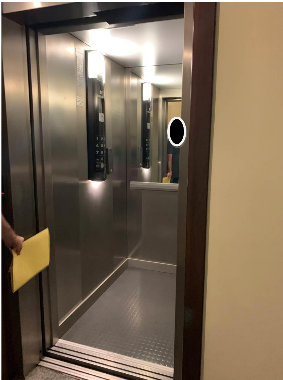
Fotografia n. 11 – Particolare dell'ascensore a servizio della Scala C, accessibile ai portatori di handicap
