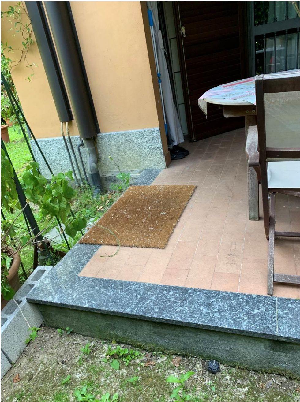
Fotografia n. 22 – Particolare del pavimento del portico e, a sinistra, della nicchia all'interno della quale è alloggiata la caldaia
