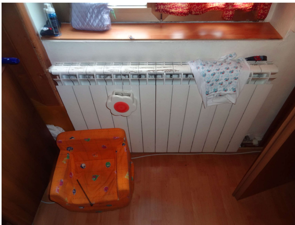
Foto interna – dettaglio radiatore
