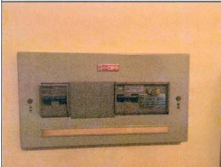
Particolare del quadro elettrico dell'abitazione
