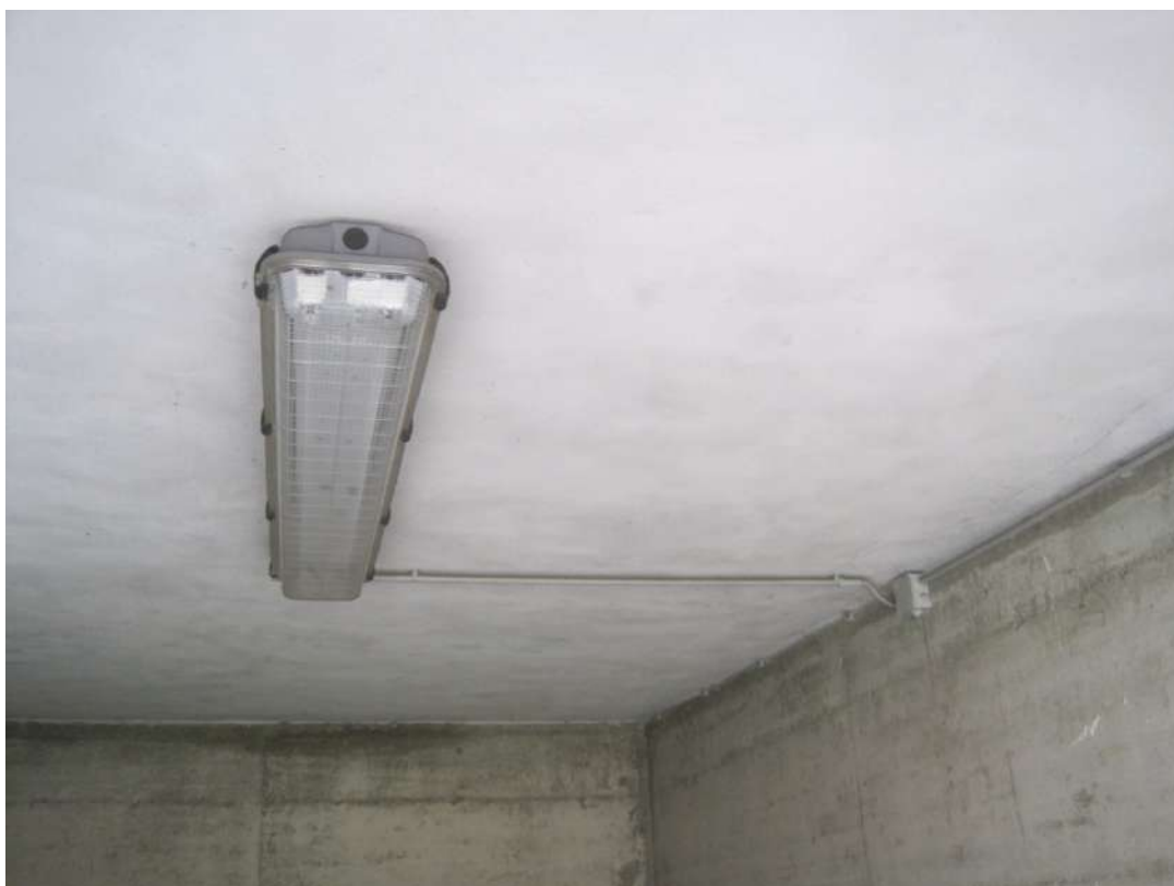
Dettagli – Impianto elettrico e di illuminazione del box-auto pertinenziale
