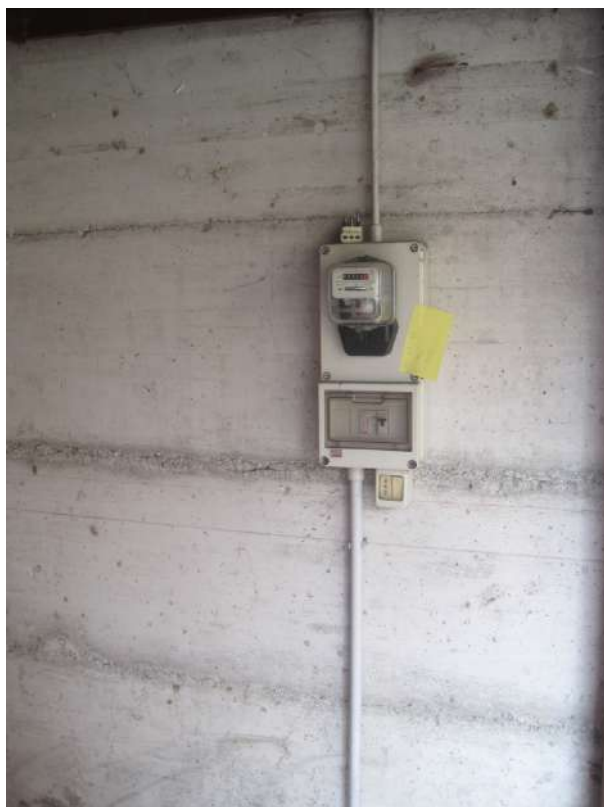
Dettagli – Impianto elettrico e di illuminazione del box-auto pertinenziale
