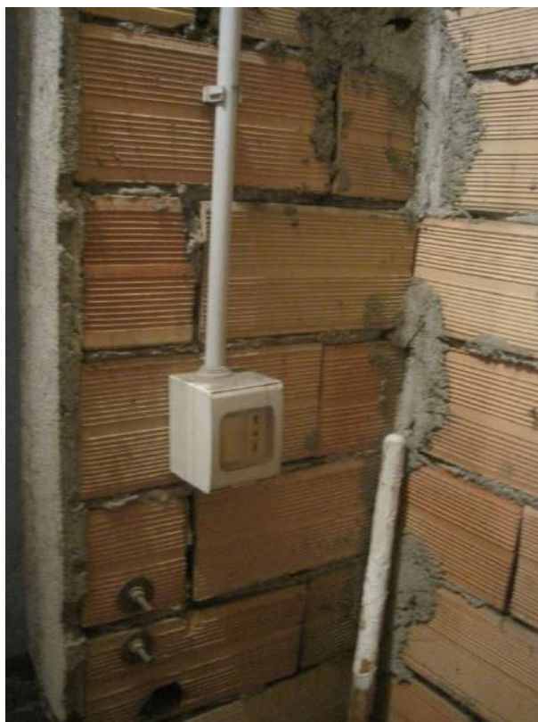
Dettagli – Impianto elettrico e di illuminazione della cantina
