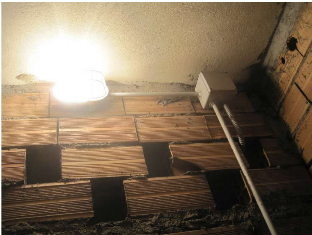
Dettagli – Impianto elettrico e di illuminazione della cantina
