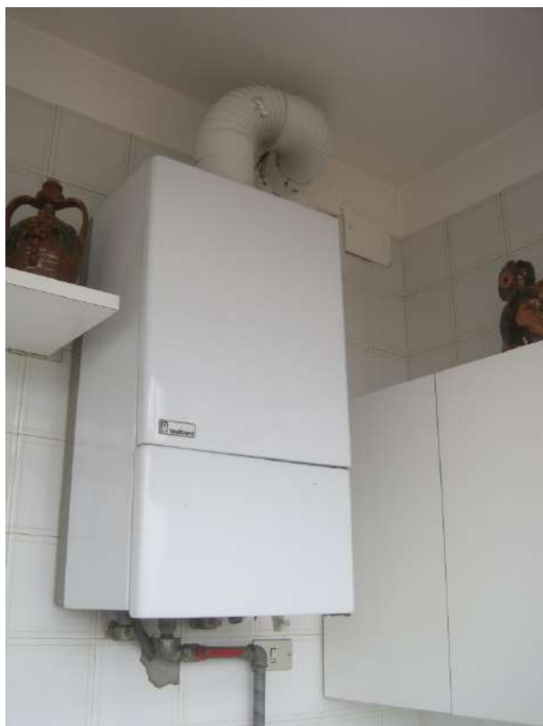
Dettagli – Caldaia per riscaldamento e produzione acqua calda sanitaria
