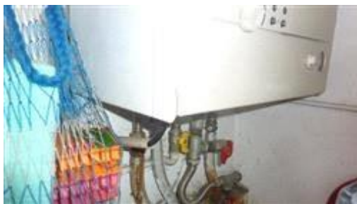
CALDAIA SU BALCONE
