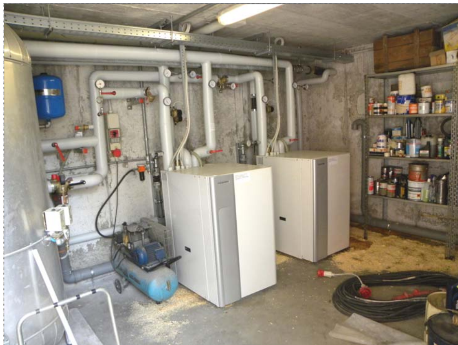
Compendio aziendale - Pordenone, via Roveredo 52/C: pompe di calore
