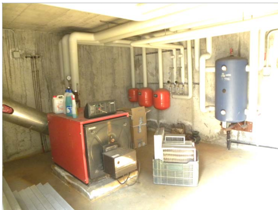
Compendio aziendale - Pordenone, via Roveredo 52/C: caldaia a gasolio
