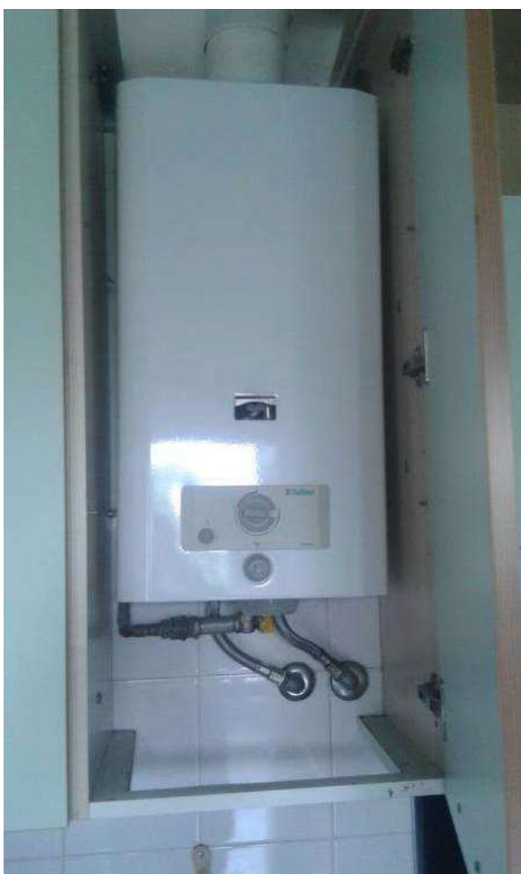
20. Dettaglio della caldaia per l'acqua calda posta in cucina.
