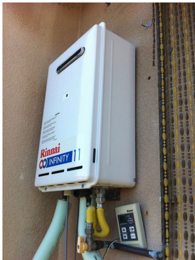
Vista caldaia per ACS sul balcone
