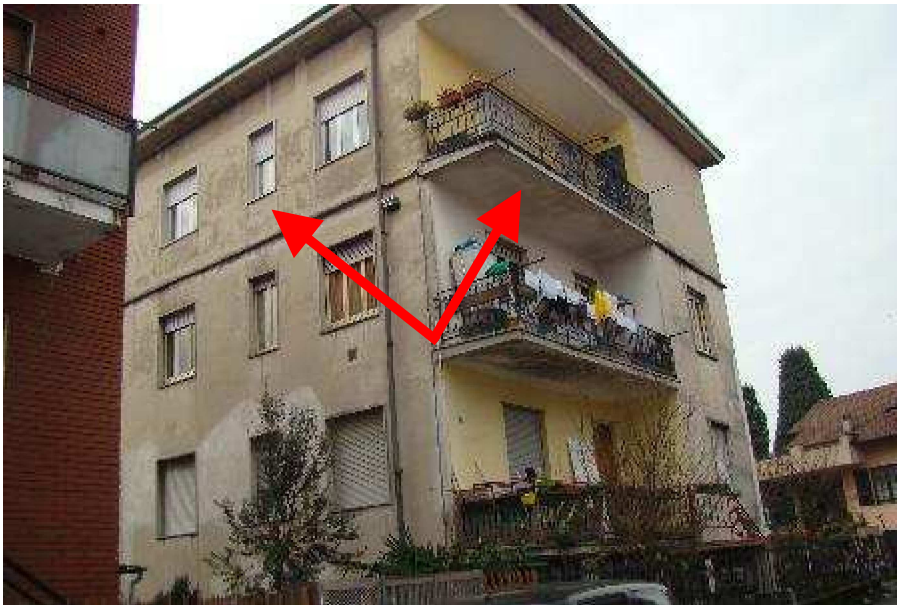
2. Vista dell'edificio, con indicazione degli affacci dell'alloggio.
