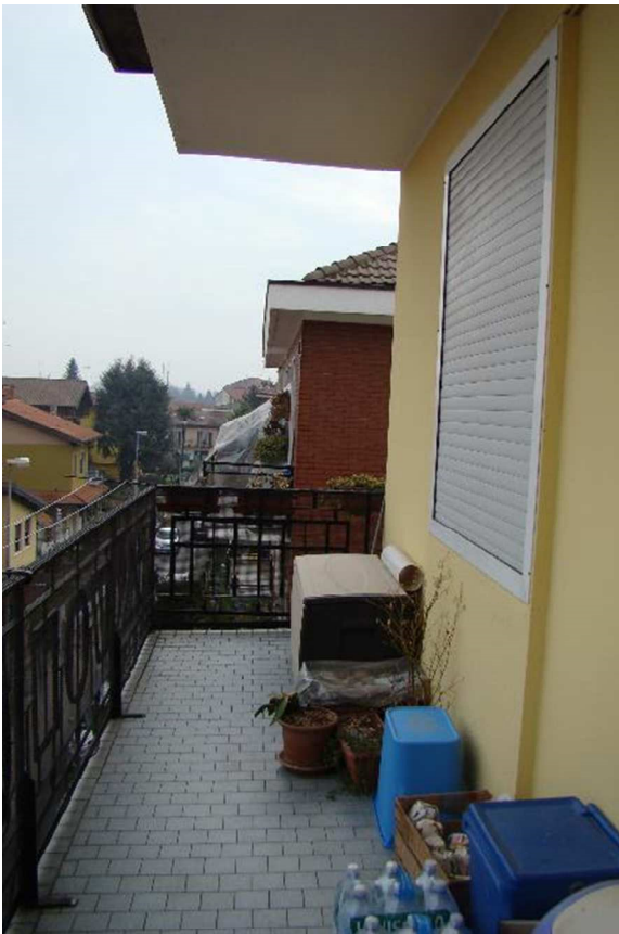
12. Vista del balcone e della finestra tamponata dall'interno.
