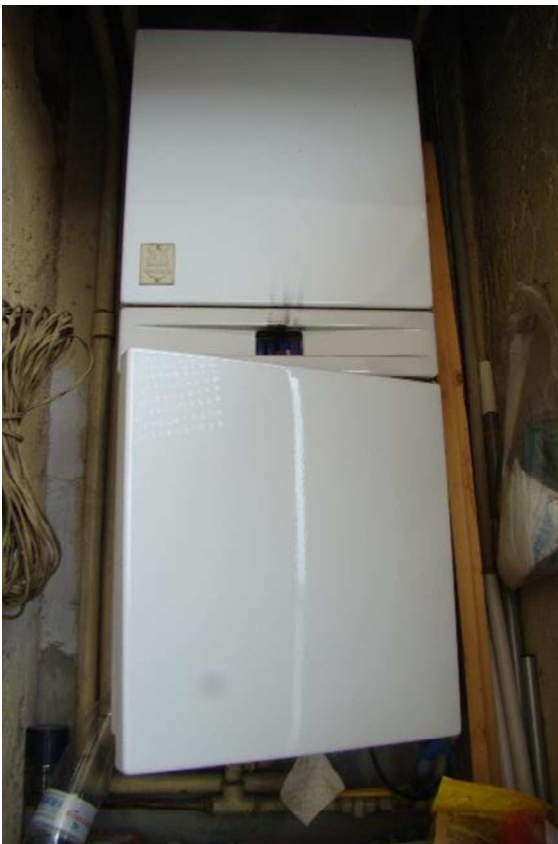
10. Dettaglio della caldaia.
