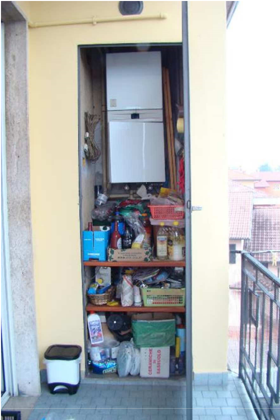
13. Dettaglio dell'alloggiamento esterno della caldaia.
