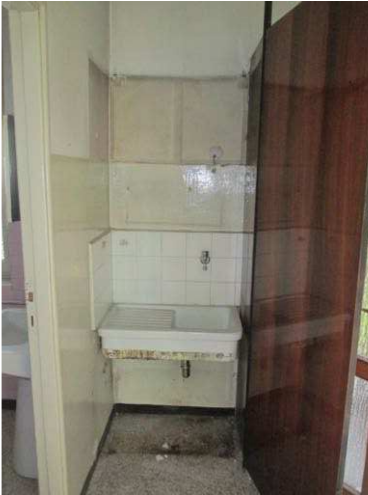
Lavello posizionato dietro la porta di ingresso
