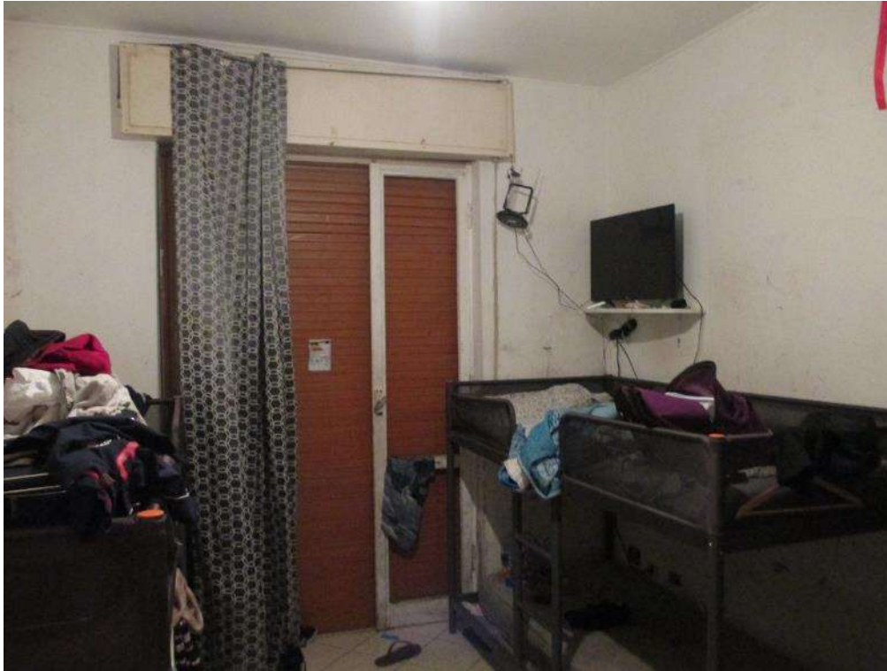
Foto 4: soggiorno adibito a camera (manca il vetro dell'infisso)
