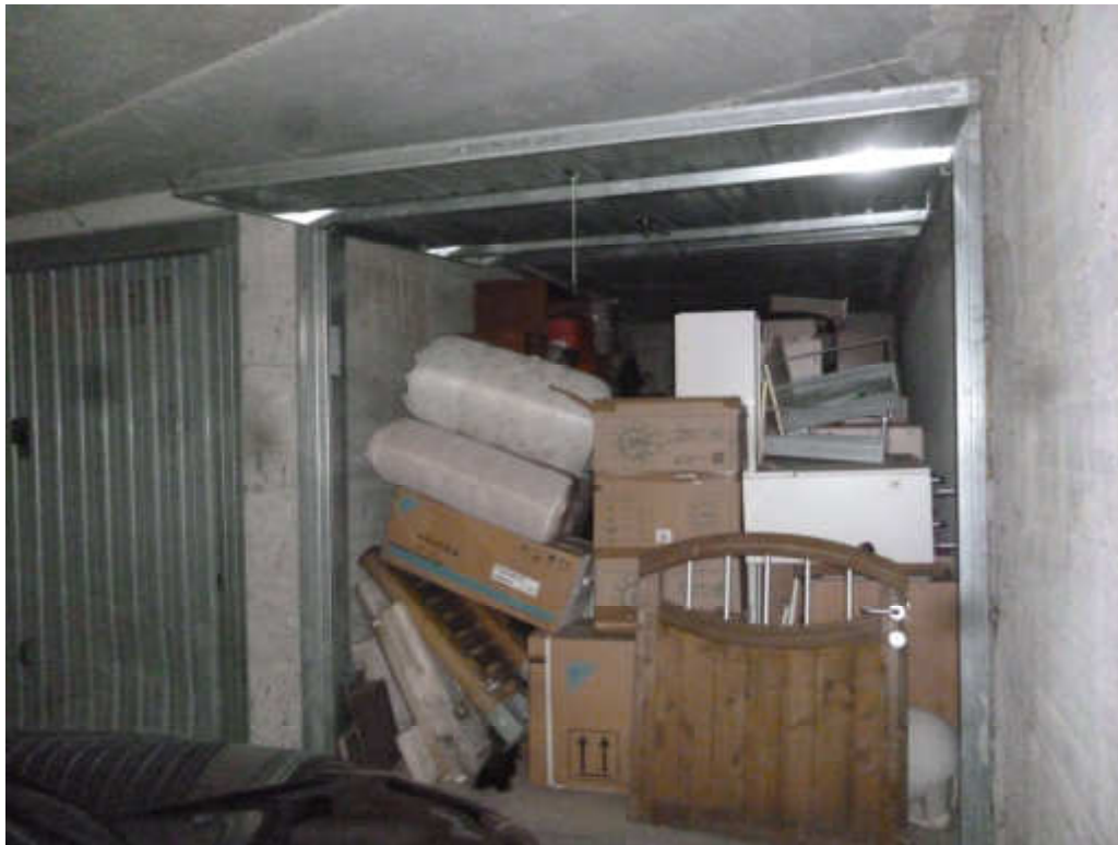
FOTO 20 – Box Sub. 25, stato attuale: ingombro ed inaccessibile
