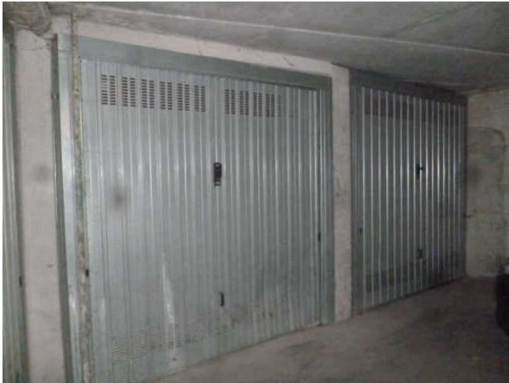
FOTO 16 – Box Sub. 24 a sinistra e Box Sub. 25 a destra. La basculante del Sub. 24 è bloccata dal tamponamento interno.
