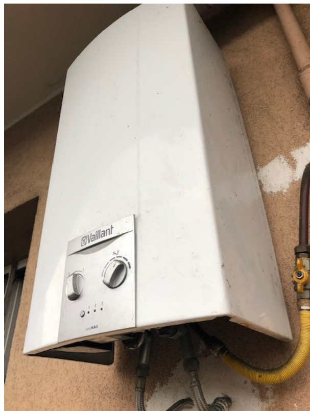
Caldaia acqua calda sanitaria
