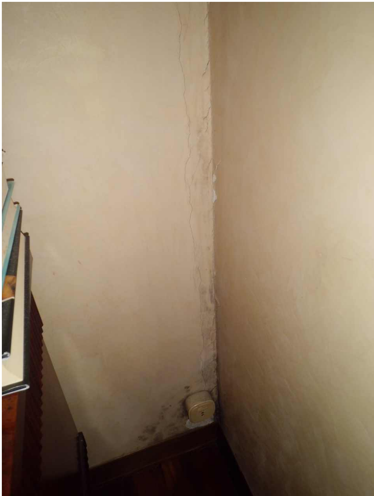
Foto n° 11 - 28/08/2017 - Comune di Porcia, foglio 3, part. 1344, sub.3 - Camera ad uso matrimoniale. Particolare delle pareti che risultano danneggiate.
