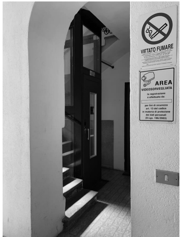
Scala con ascensore lato destro
