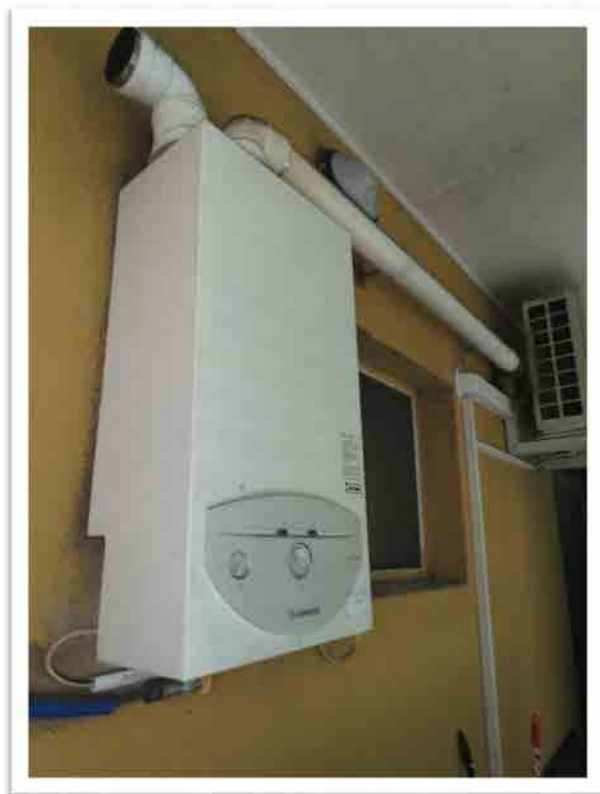
Particolari della caldaia a gas per la produzione dell'acqua calda per uso sanitario e del serramento esterno.
