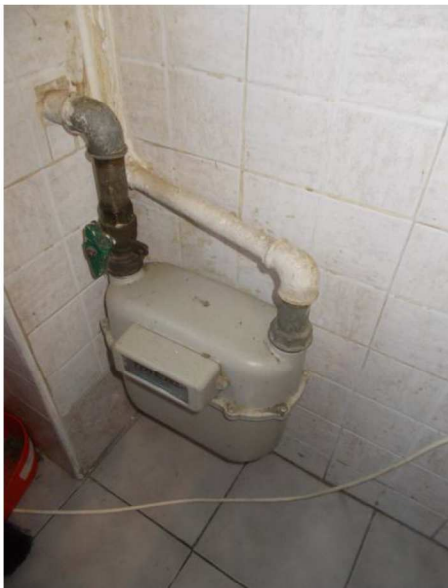
47. Contatore del gas interno (in cucina)
